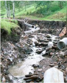
▲ Hochwasser hat zu einer schlagartigen Erosion geführt. Ein Gehölzsaum hätte dem entgegen gewirkt.
