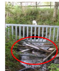
▲ Geschwemmselrechen vor einem Durchlass schützt vor Verklauung
