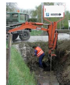
▲ Ständig wiederkehrende Sohlräumung vor einem Durchlass. Eine Brücke würde hier die Situation dauerhaft verbessern.
